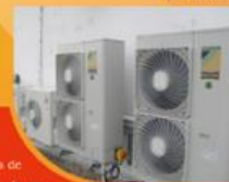
Des installations adaptées à vos besoins, du particulier à l'industrie, en passant par le tertiaire
